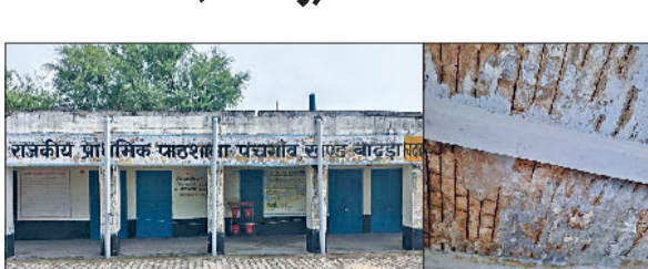
बाढ़ड़ा। राजकीय प्राथमिक विद्यालय का भवन जर्जर भवन का दृश्य व स्कूल के भवन की छत में निकले सरिरे। फोटो: हरिभूमि
